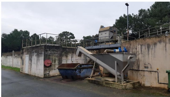
Figure 1 : Photographie des ouvrages de prétraitement (Source : Eau-Mega, Novembre 2021)
