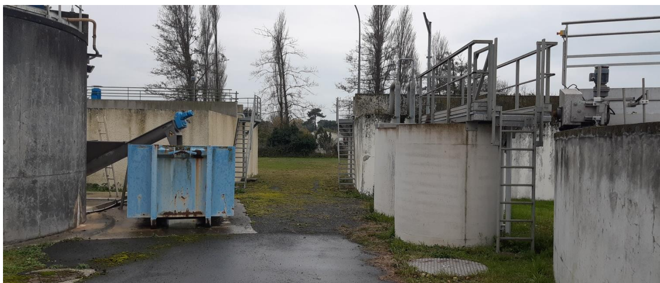
Figure 1 : Photographie de la filière eau de la station d'épuration de Saint-Trojan-les-Bains (Source : Eau-Mega, Novembre 2021)
