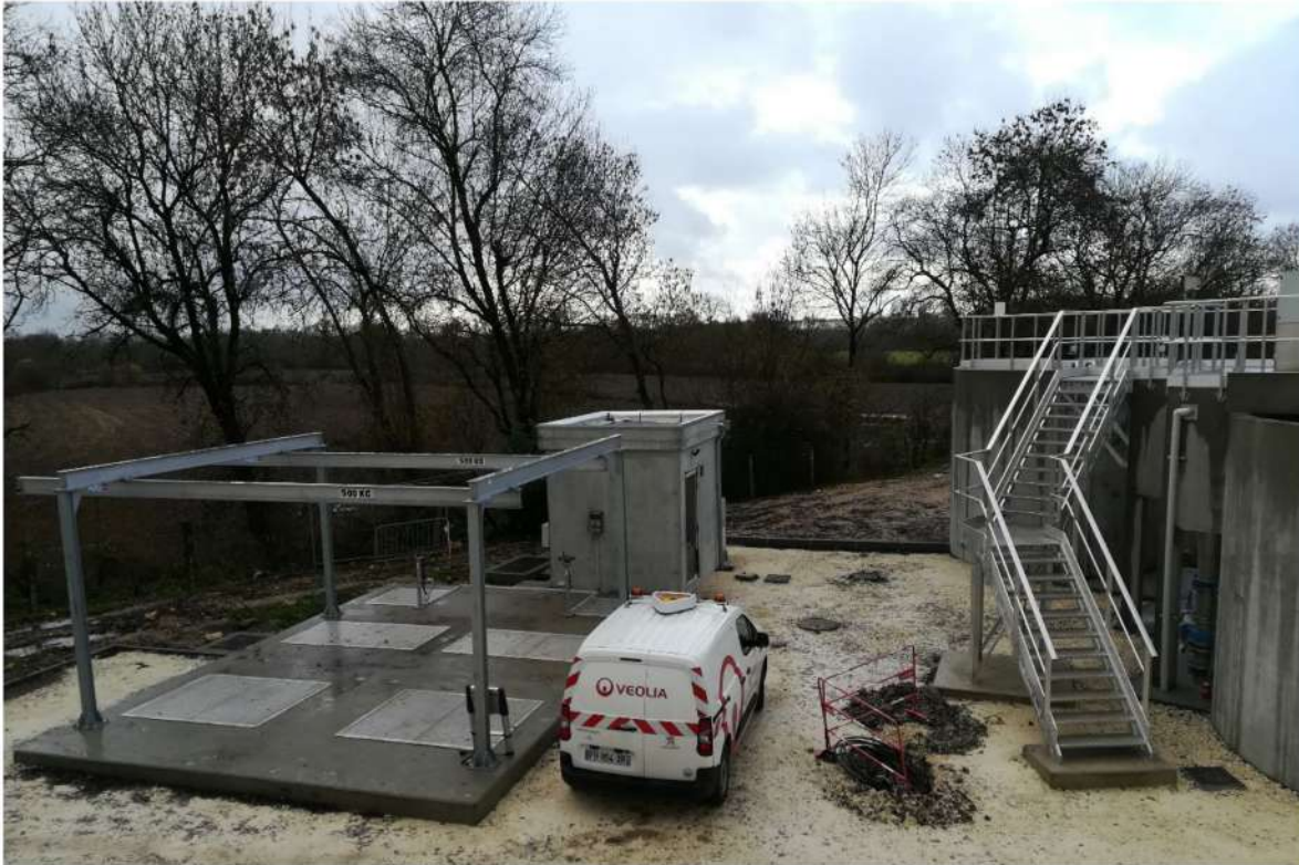
Photographie du nouveau poste de relevage (novembre 2021)
