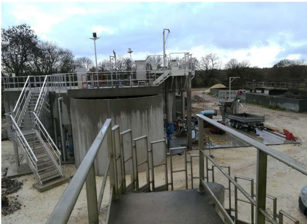
Photographie des nouveaux prétraitements (novembre 2021)
