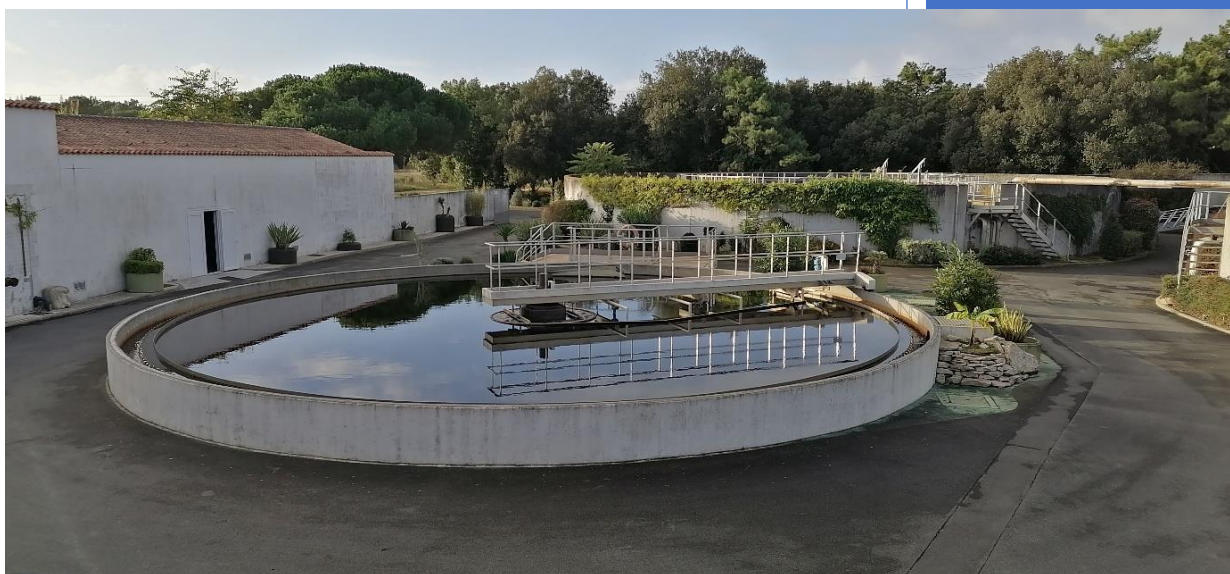
Vue du clarificateur – Source Maîtres Cubes
