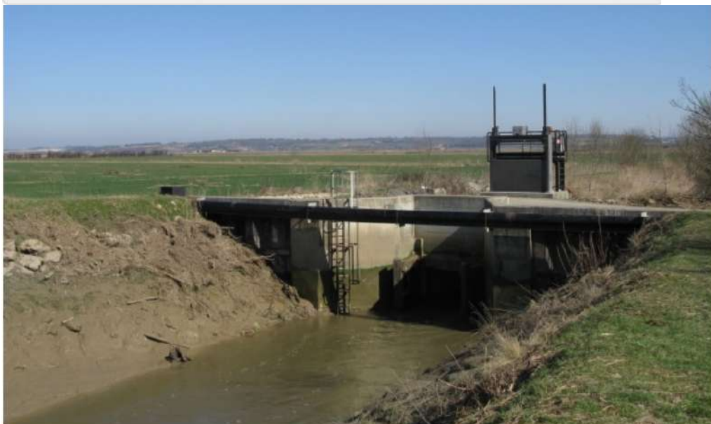
Chenal et porte éclusière du Port de Cognaç, canal du Centre - La porte du canal du Centre, vue en aval.
