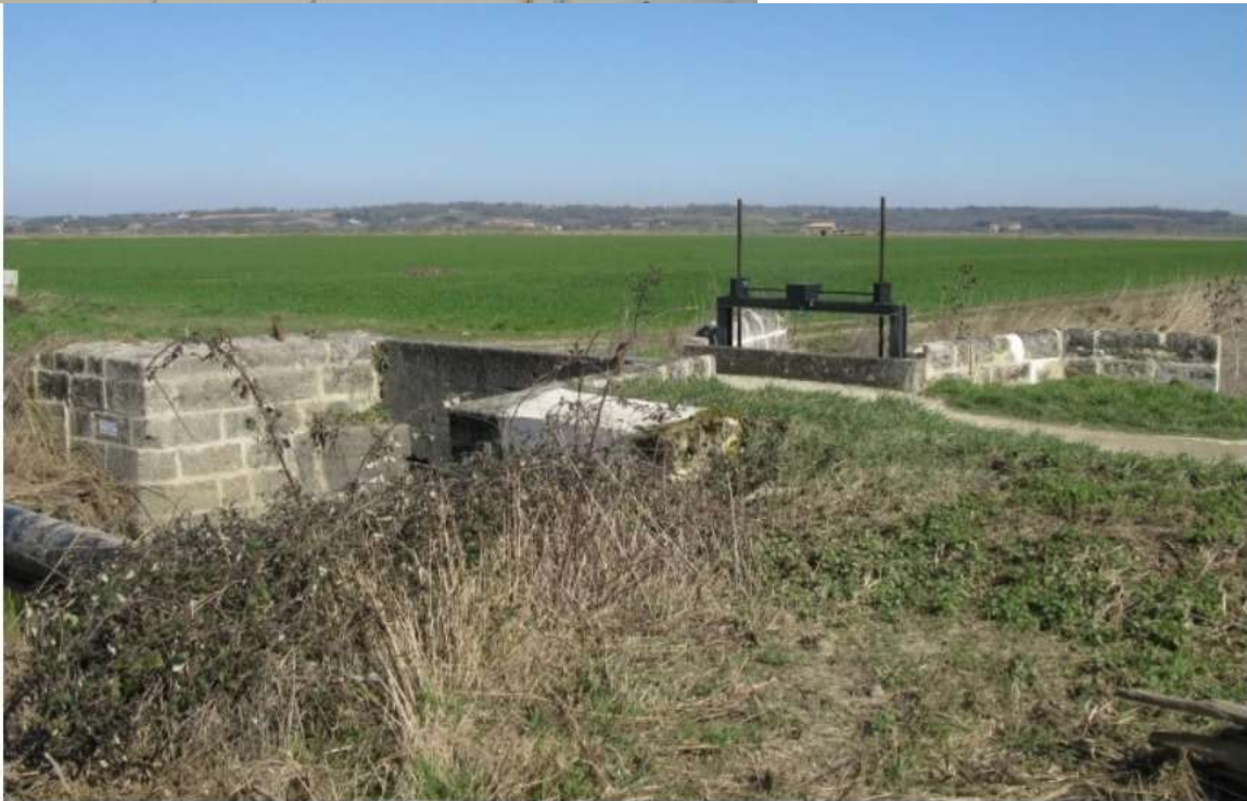
Chenal et porte éclusière du Port de Charron, canal de Charron - La porte de Charron vue depuis le sud-ouest, en aval.
