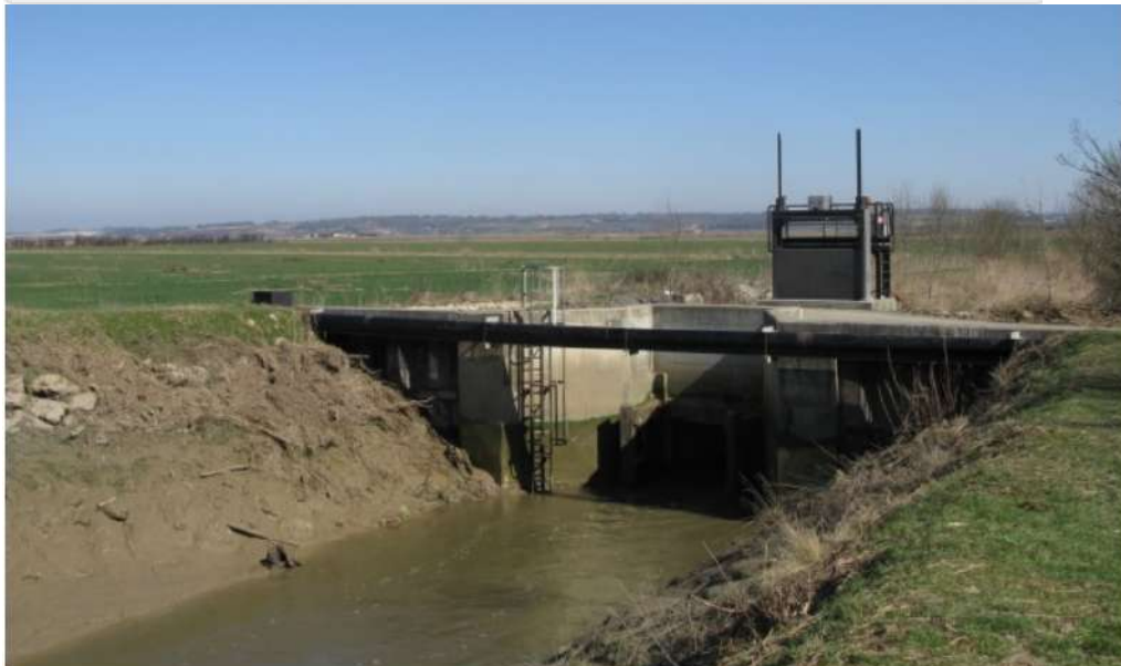
Chenal et porte éclusière du Port de Cognaç, canal du Centre - La porte du canal du Centre, vue en aval.
